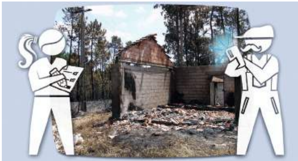
Fig. 77 Avalie os danos no edificado.
